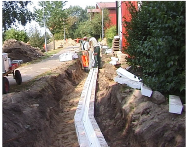
Metoden att lägga PEX-rör i isolerblock testades för några år sedan i Värnamo med lyckat resultat, enligt föreningen svensk Fjärrvärme.
