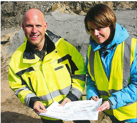
Christina Hallgren visar C4 Energis nya fjärrkylennät på kartan för Göran Olsson från Elgocell som levererat isoleringsmaterialet.
